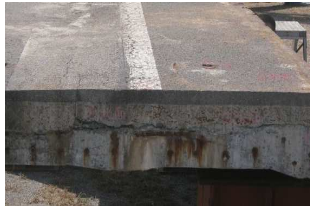
図 コンクリート床版中の水平ひび割れ
